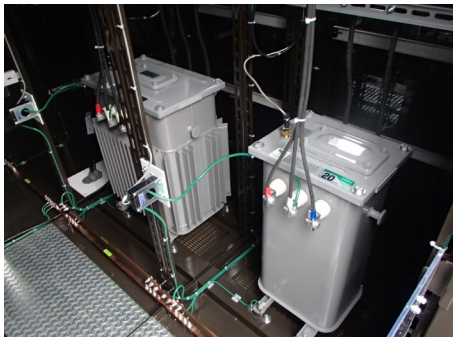
省エネ性能の高いトップランナー変圧器の設置
