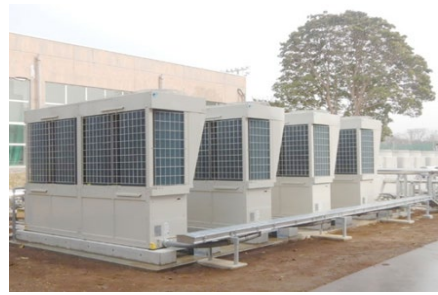
屋内プール熱源設備改修によるエコ給湯機の設置
