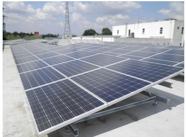
中央機械室屋上太陽光パネル
