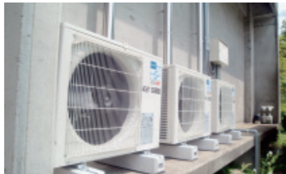
陸域環境研究センターの空調機用室外機
