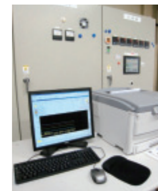
中水化処理制御の監視盤
