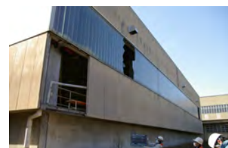
総合体育館の損壊状況 (震災当時)
