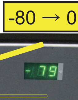
停電時の写真がないので、 正常時の温度表示
