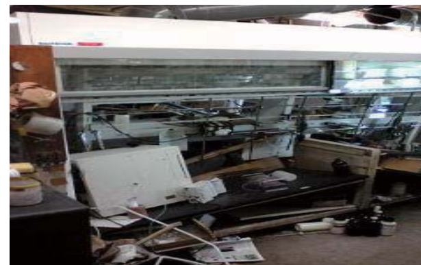
スチール製ベンチフード、倒壊した実験台ともに床に落下、変形、ダクトと電源系破損
