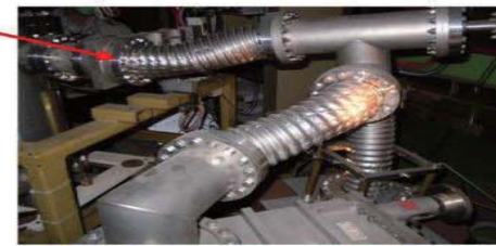
7階 絶縁ガス流出による真空ライン破損
