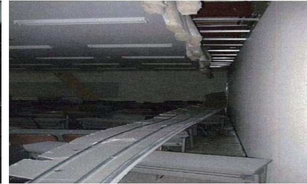
講義室の天井落下
