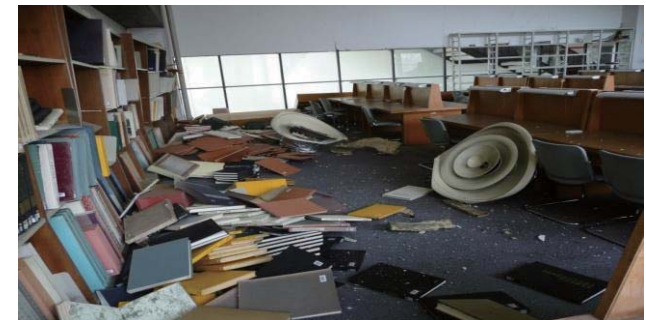
棚損壊、空調機落下
