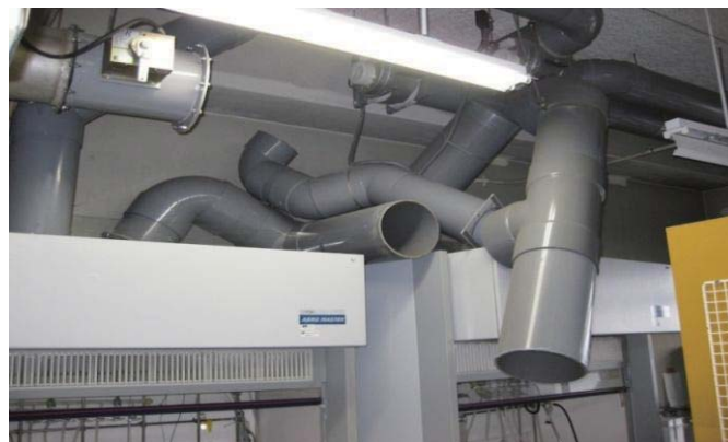
ドラフト排気系の損壊
