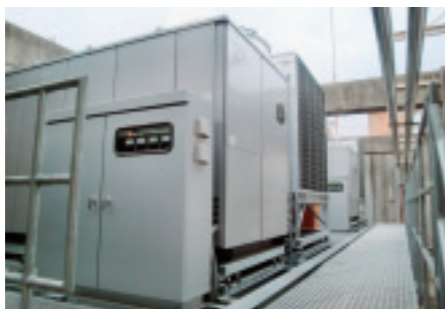
冷温水発生器
