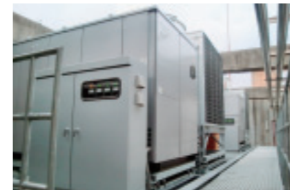
冷温水発生器
