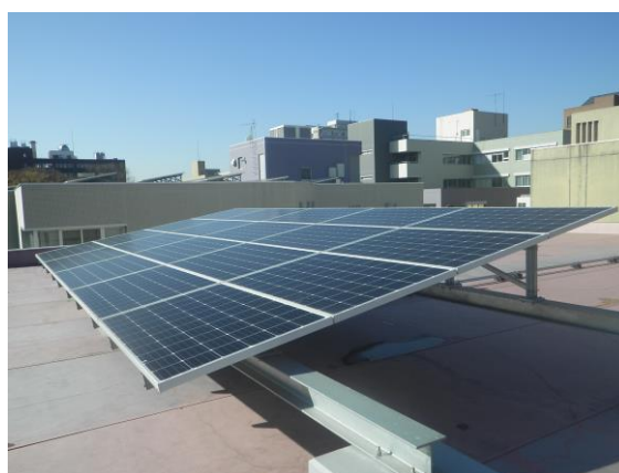
1H棟屋上太陽光パネル
